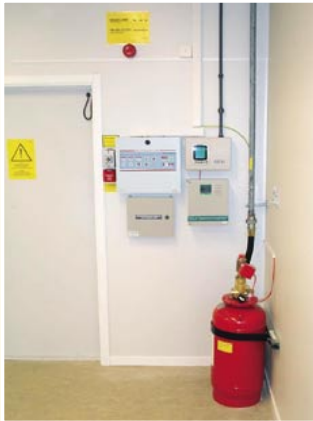
En komplett installation av ett EX-200 släcksystem med UniLaser XL som aktiveringssystem i kombination med rökdetektorer. Utrymmet som skyddas är ett teleutrymme på c:a 75 kubikmeter och som skyddas med 47 kg FM-200 släckmedel.
