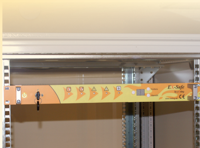
EX-Safe 1U monterad högst upp i 19" rack
